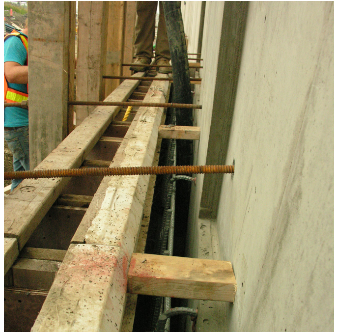
Photo 3 : Haut de la glissière avec ouverture inférieure à 200 mm lors du bétonnage (Québec, 9 août 2013) Source : Nadia Pouliot
