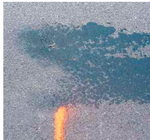
Photo 1 : Remontée de bitume en raison d'une contamination
